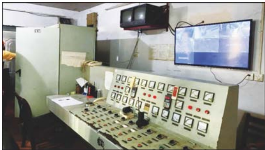
a) 老充填站控制系统
