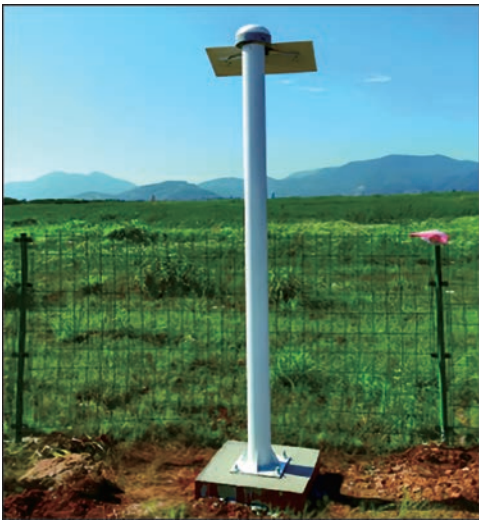
图4 铜绿山尾矿库在线监测站
