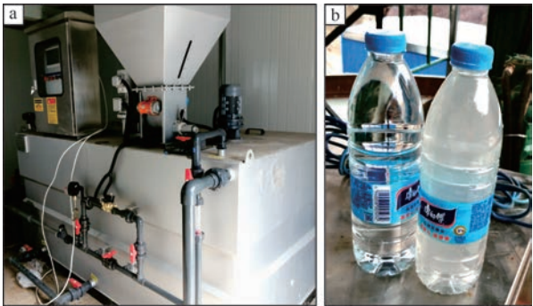
图 9 絮凝剂活化加药装置及澄清的溢流水
