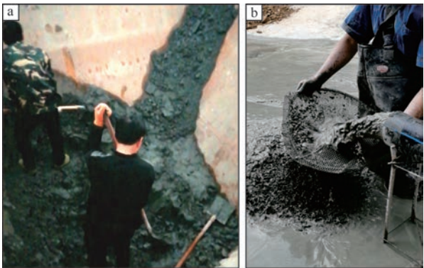
图 3 添加絮凝剂后料仓堵塞和充填料浆结块现象
